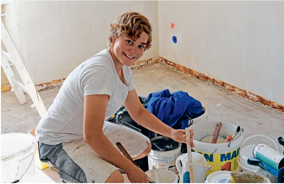
Valeria Blatter bereitet die Farbe vor für den anschliessenden ersten Anstrich in einem Renovationsobjekt.
